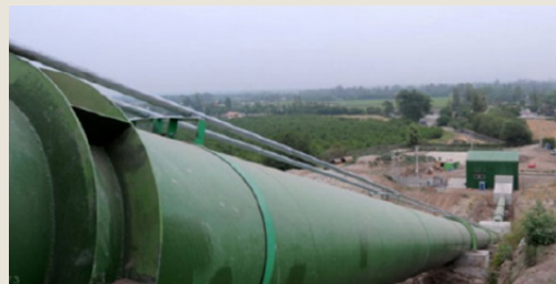
GTD, Central Hidroeléctrica Las Vertientes.
